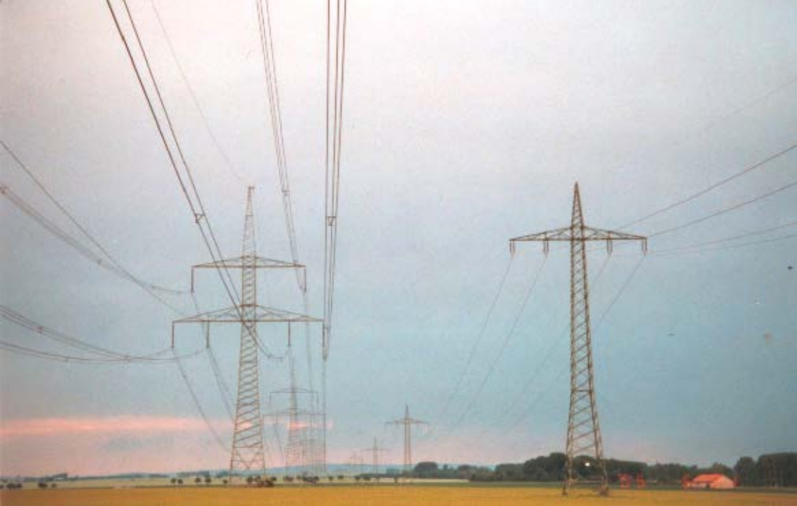
Bild 12: Leitungen der Wiedervereinigung, Nähe Gotha, 380 kV, 50 Hz und 110 kV, 16 2/3 Hz
