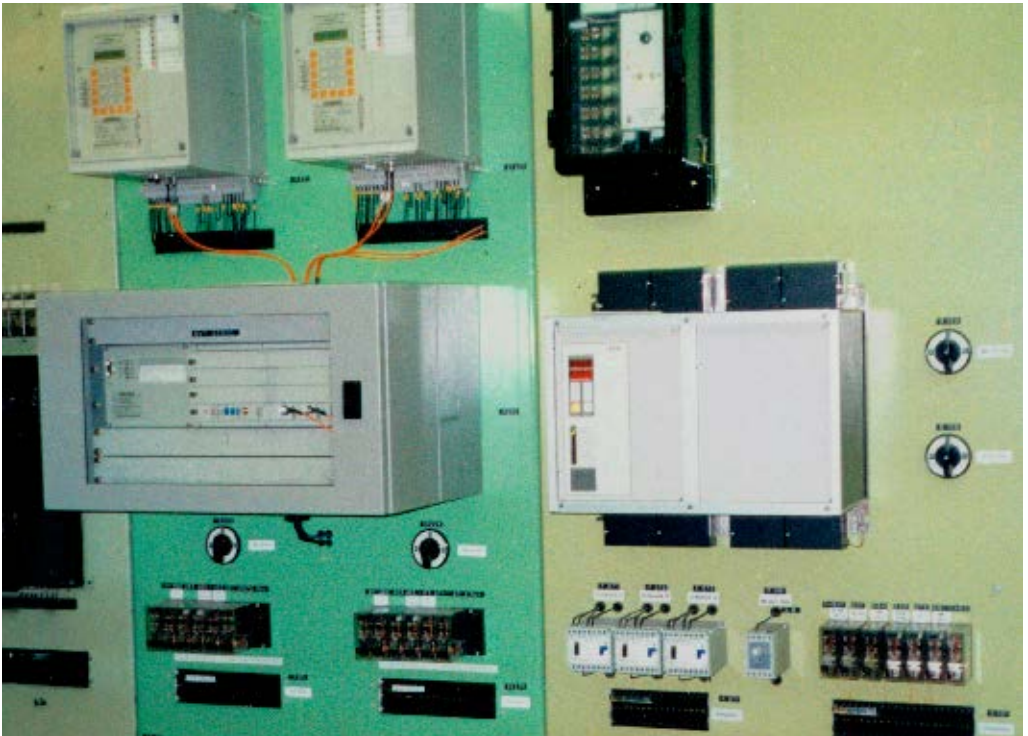
Bild 14: Schutz UW Remptendorf, Abg. Redwitz 253/254, Hauptschutz Distanzrelais PD551 mit AWE-Zusatz RM1-80, AEG und Reserveschutz Leitungsdiff. 7SD512 mit Signalübertragungsgerät SWT2000D, Siemens
