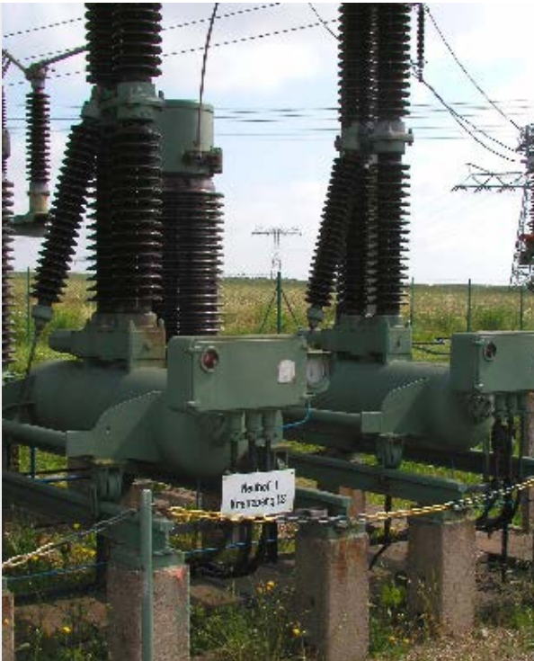
Bild 8: UW Wolframshausen, 110-kV-Schaltfeld Neuhof 1
